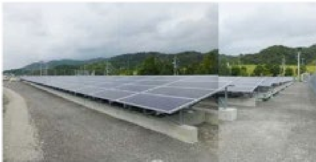
鳴門衛生センターソーラー（ゴミ焼却炉移転跡地） 300kW
