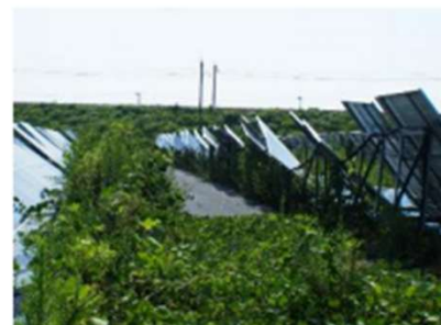
不十分な管理で放置されたパネル
