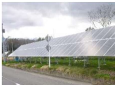
柵塀の設置されない設備
