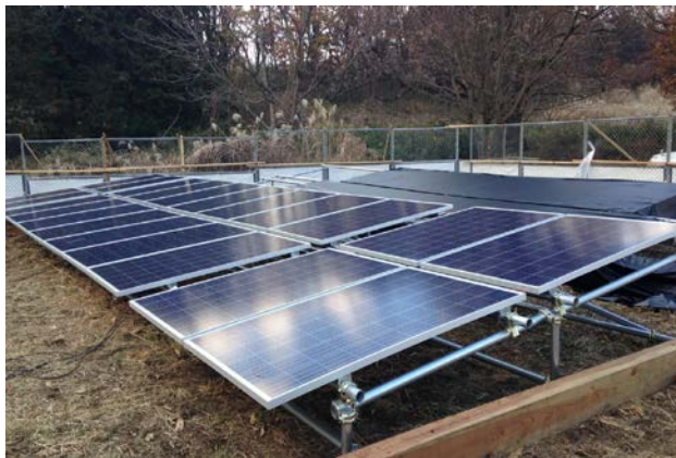
写真1 水没実験に用いた太陽光発電設備
